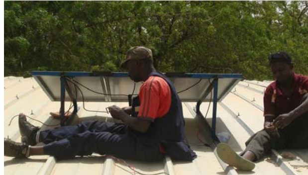
2012: Installation einer PV-Anlage auf der Grundschule in Gando—aber wer wartet sie jetzt??
